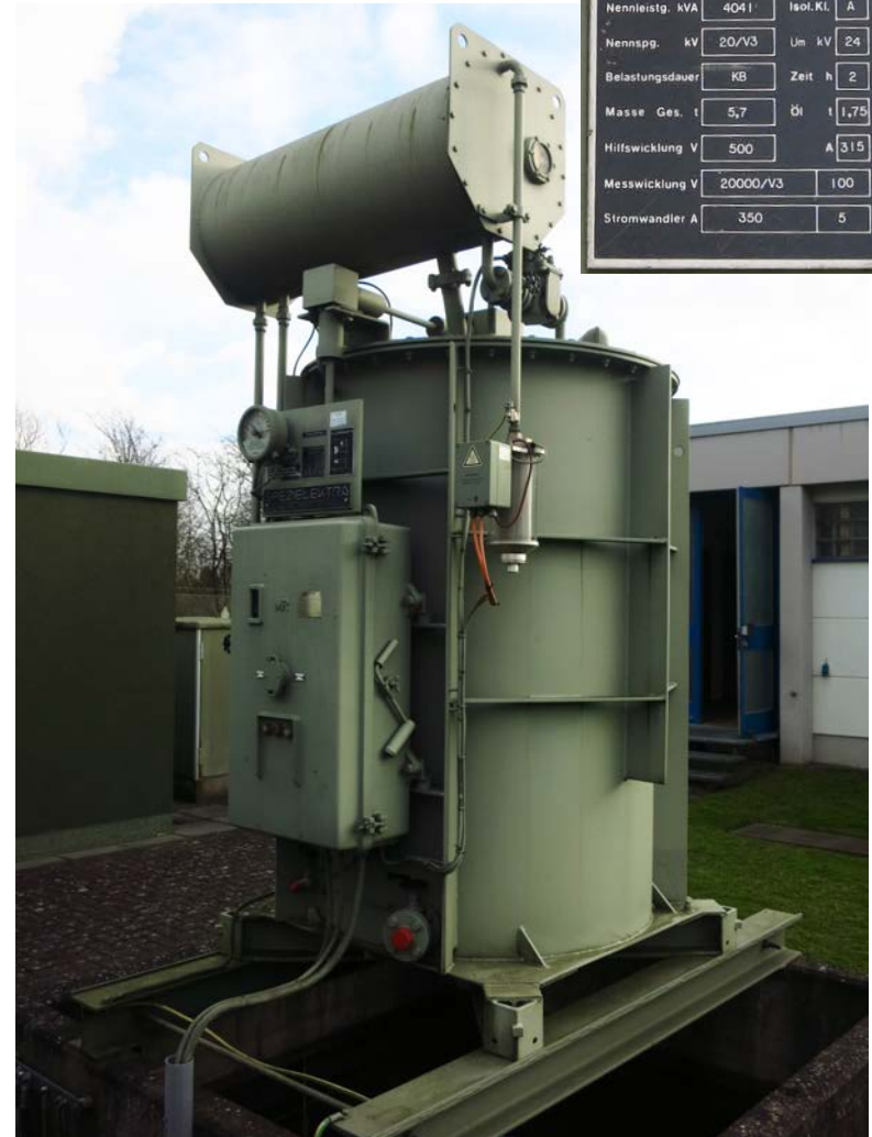
Peterson-Spule 20 kV / 350 A mit elektrischer Verstellung
